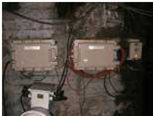
< 基地局設置状況 >
